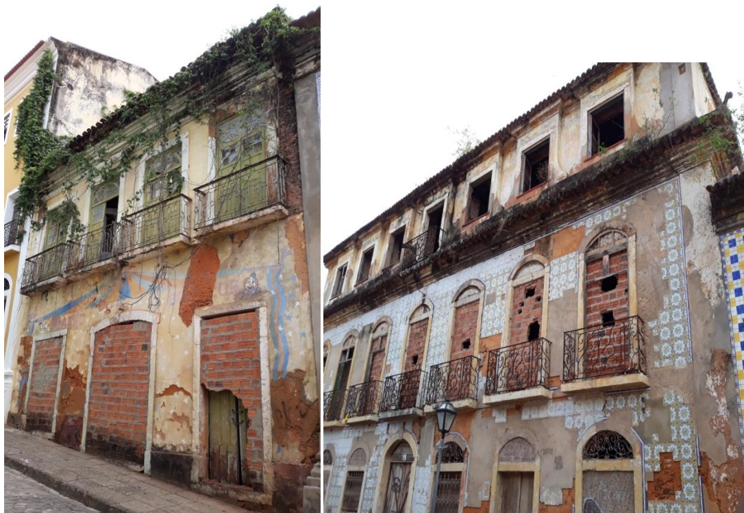
Fotografia 6 – Casarões abandonados. À esquerda na Rua do Giz. À direita na Rua 28 de Julho. Fonte: Registro fotográfico do autor (2018).
