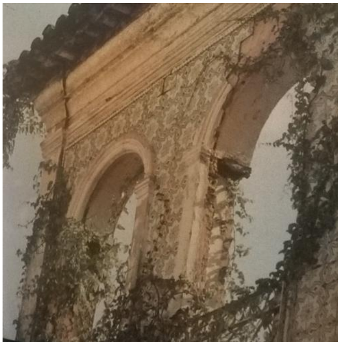
Fotografia 20 - Verso: Os sobradões sem telhados são armadilhas de sorrateiro interesse. P. 56. Fonte: Cruz, 1997. Digitalização do autor.
